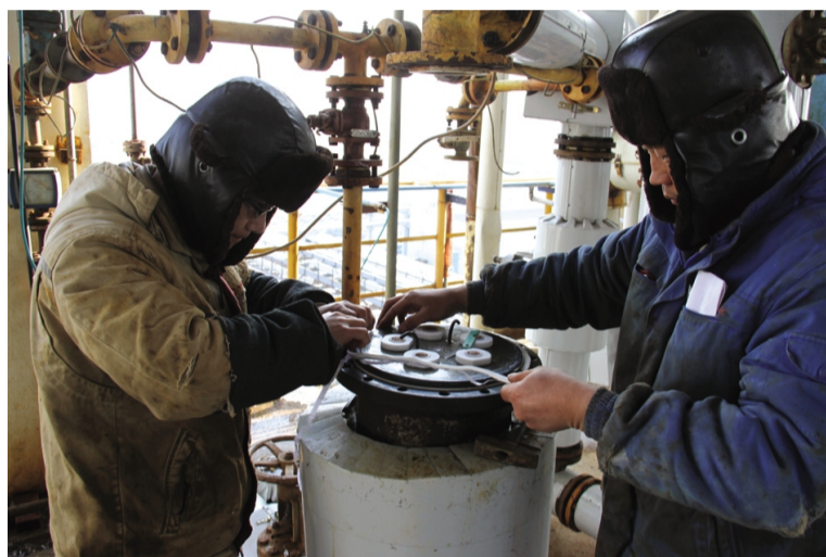
为保证生产装置节日期间安全生产,连日来,利海化工公司集中时间组织维修人员对各装置设备进行一次全面“体检”。图为维修人员正在更换氯化钾装置氯气过滤器滤芯。(郁洪兵)
