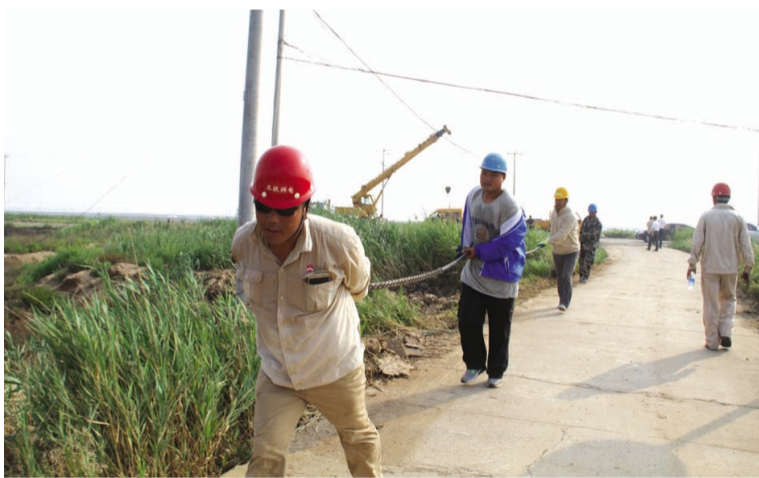
连日来,受持续高温天气影响,电网负荷出现大幅增长。近日,供电公司施工人员顶着烈日对配电台区及部分线路设备进行改造,确保高温期间生活和生产用电可靠。(徐静)
